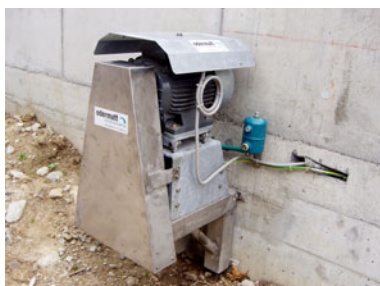
Motor an Gruben-Aussenwand montiert.
