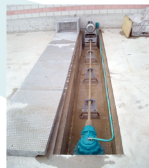
Getriebe in Betondecke versenkt, Motor an Wand oberflur
