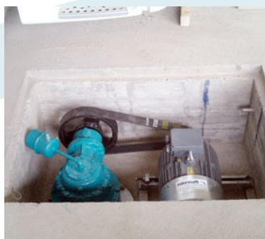
Getriebe und Motor in Betondecke versenkt
